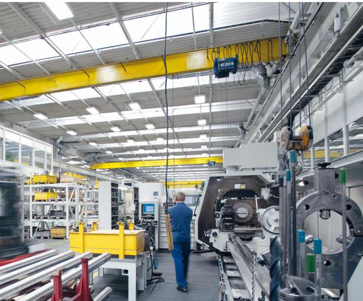
Engel Werke, St. Valentin, Schwertberg und Dietach | AT Elektroinstallation: G. Klampfer Elektroanlagen GmbH, Leonding | AT Lichtlösungen: Lichtmanagement LUXMATE LITENET mit Automatisierungsrechner, Server, Tageslichtmesskopf, Gateway und Software, Hallenleuchte VALUEA auf TECTON Tragschienen
