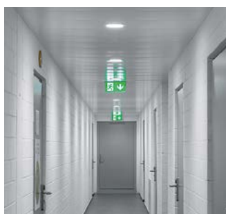
Rettungszeichenleuchten weisen im Notfall den Weg ins Freie.
